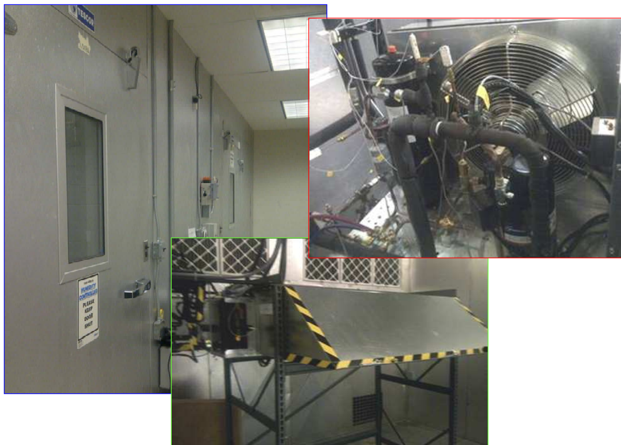
Photos des 2 chambres réfrigérées contenant respectivement l'unité d'évaporation (photo du bas) et l'unité de condensation (photo à droite)
